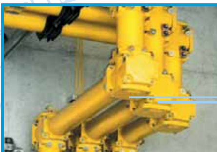
GL 12 kV – 2500 A
