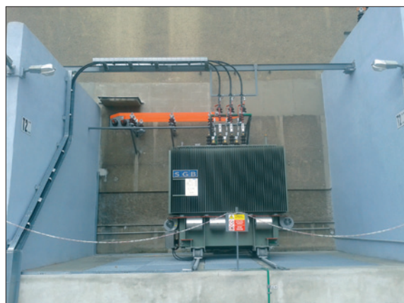
Obr. 2. Příklad instalace v Teplárně Přerov jmenovitý výkon 12,5 MV·A, jmenovité napětí 23 \text{ kV} \pm 2 \times 2,5 \% / 6,3 \text{ kV} , skupina zapojení YNd1, ztráty naprázdno P_0 = 9,1 \text{ kW} , ztráty nakrátko P_k = 56 \text{ kW} , napětí nakrátko u_k = 8,4 \% , hmotnost je 20,3 t (z toho olej 4,4 t)
