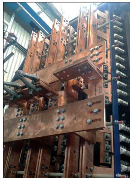
Obr. 4. Detail sekundární strany transformátoru pro zkušebnu VUT Brno
