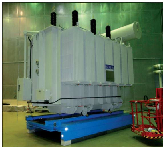
Obr. 1. Transformátor pro Pražskou energetiku, a. s., pro rozvodnu Lhotka jmenovitý výkon 40 MV·A, jmenovité napětí 110 \pm 8 \times 2 \% / 23 \text{ kV} , skupina zapojení YNyn0/d/, ztráty naprázdno P_0 = 17 \text{ kW} , ztráty nakrátko P_k = 143 \text{ kW} , napětí nakrátko u_k = 11,1 \% , hmotnost 73 t (z toho olej 16,2 t)
